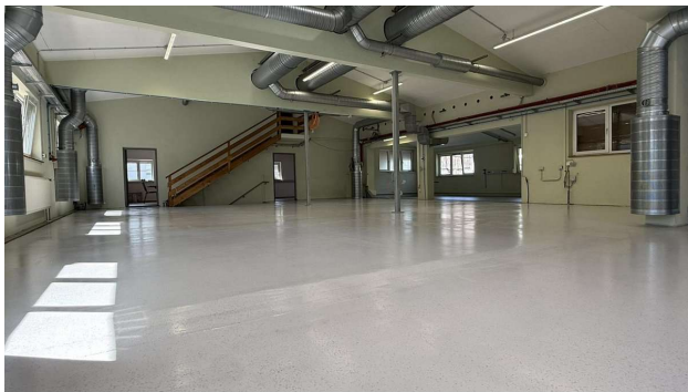
Hallenübersicht mit Lüftungsanlage
