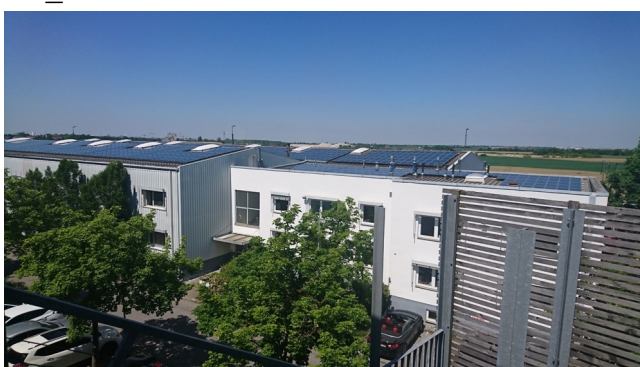
Gewerbe PV Anlage
