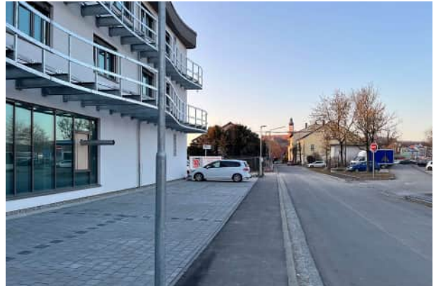
Straßenbegleitende Freilächen mit gestalterischen und funktionalen Mängeln
