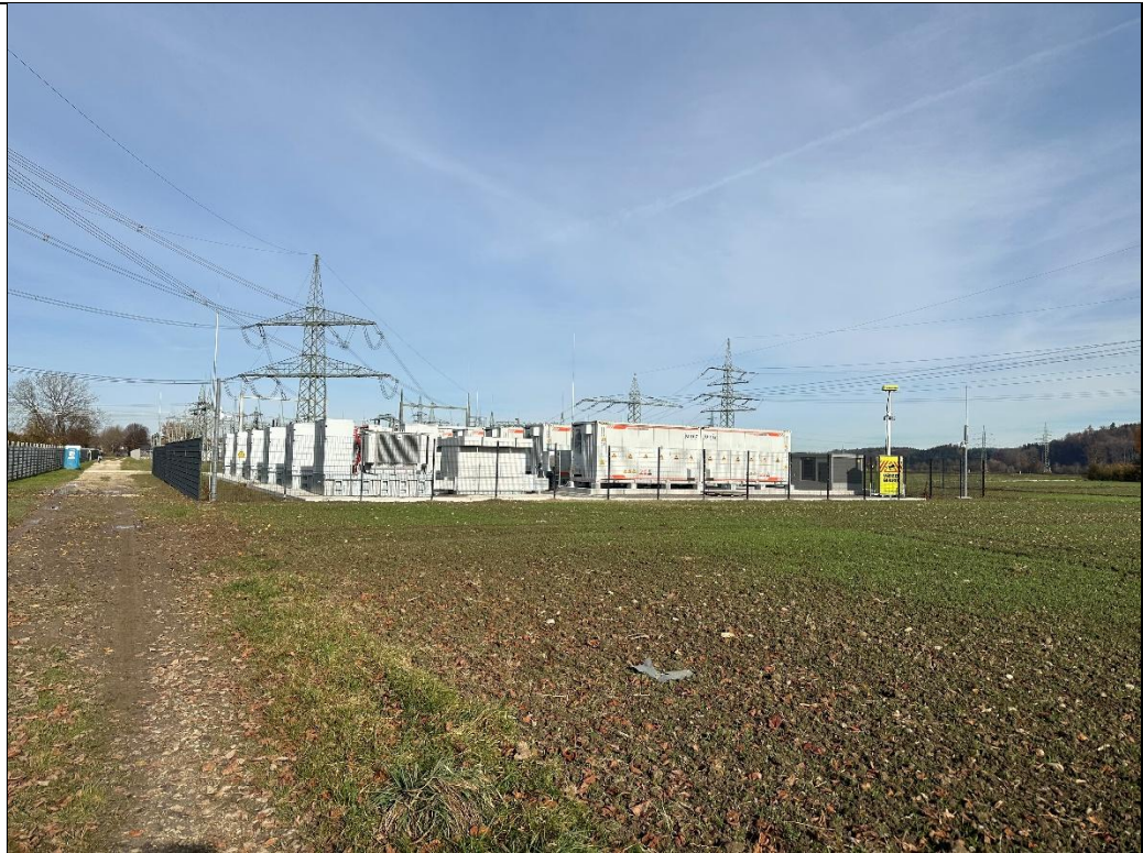
Batteriespeicher Bestand – nördlich der Eingriffsfläche, Energie Ernte Okt. 2025
