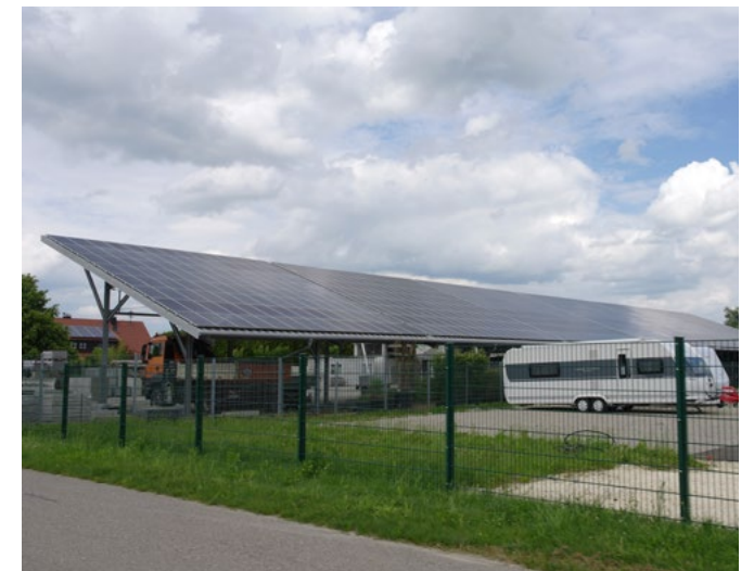
Abb. 031: Gewerbebetrieb mit PV-Dach
