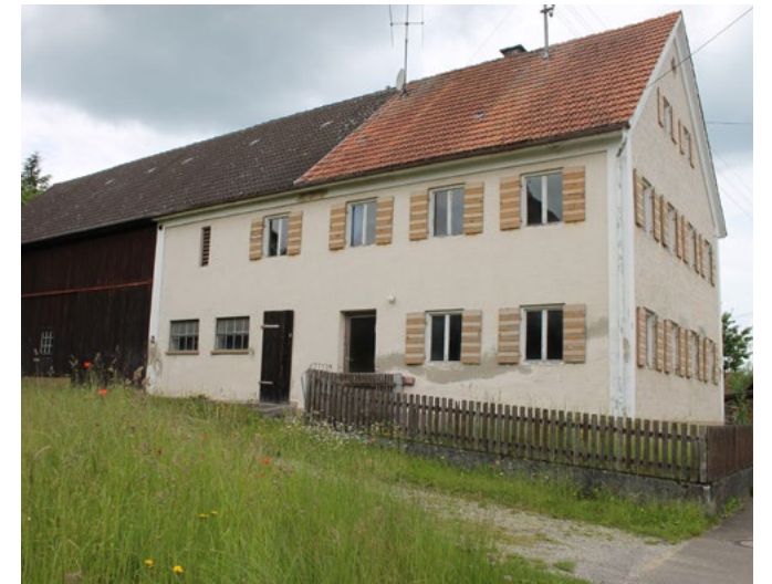
Abb. 054: Leerstand mit Sanierungsbedarf
