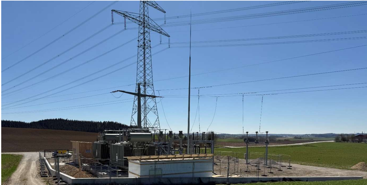
Abb. 1: Umspannwerk Sielenbach mit 110 kV und 380 kV Freileitungen
