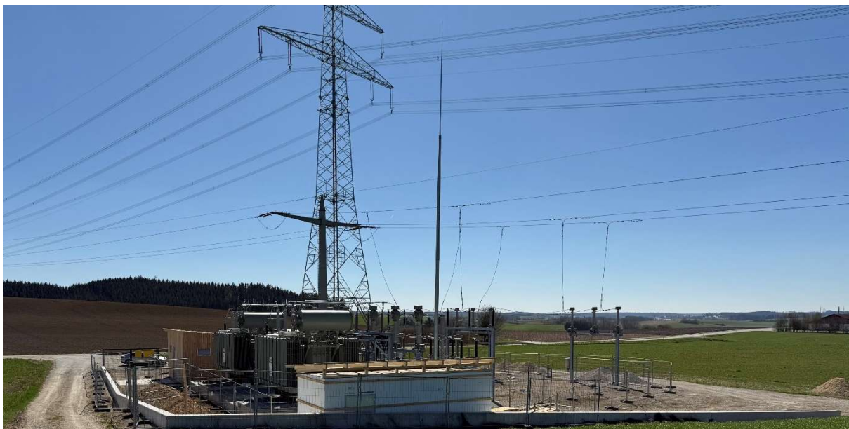
Abb. 1: Umspannwerk Sielenbach mit 110 kV und 380 kV Freileitungen
