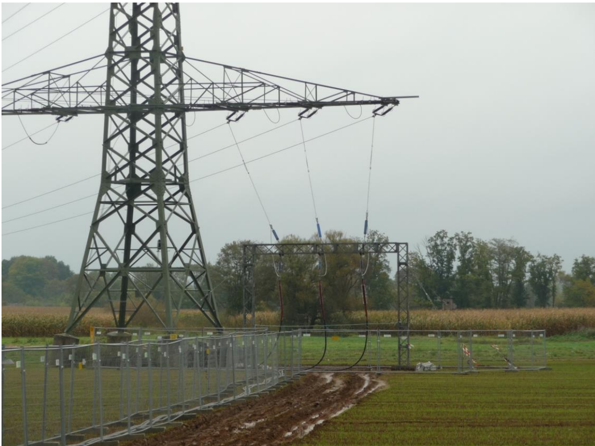
Abbildung 45: 110 kV-Kabelprovisorium mit Übergangsportal
