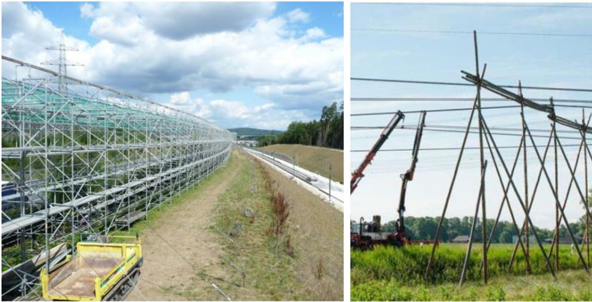
Abbildung 51: Schutzgerüste aus Metall (links) und Holz (rechts)
