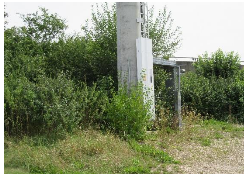
Funkmast bei neuer Lagerfläche FL2
