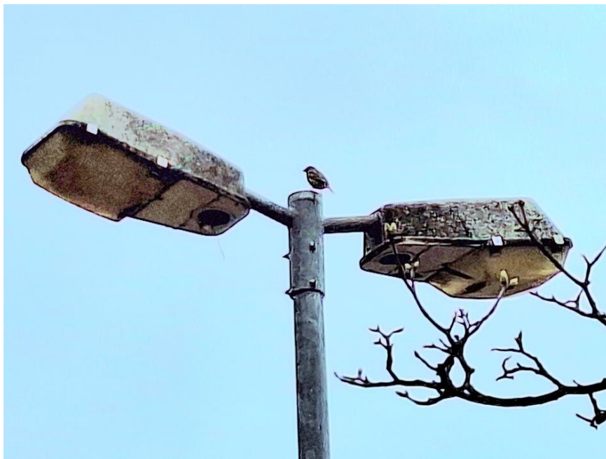
Abb. 25 Vor-Ort-Foto Parkplatzleuchte; Quelle: PV
